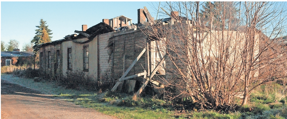
Die alten Lagergebäude auf dem Edelmann-Grundstück verfallen zunehmend.
